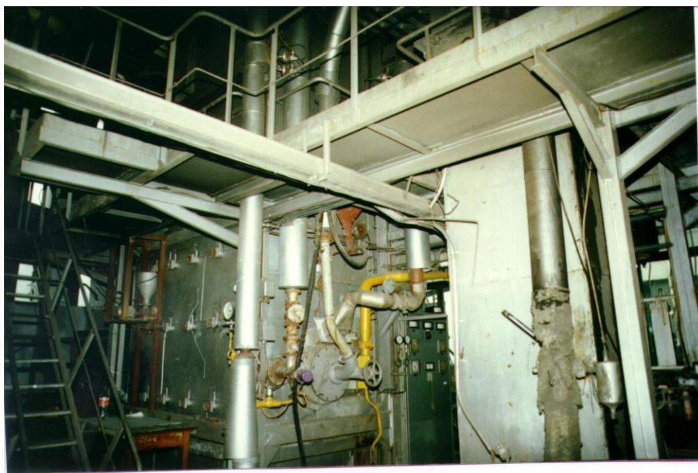
Figura 1.2.14. Vedere a sistemului de ardere și a frontului focarului de combustibil solid al Catedrei E.T.C.N.
